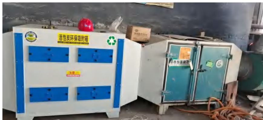
涂胶、热压废气处理设施
