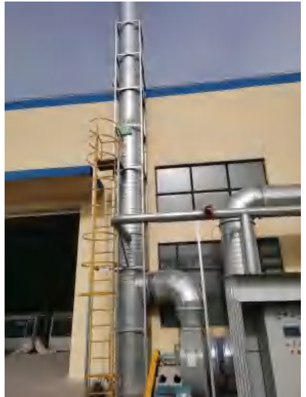
加热挤压废气处理设施及排气筒
