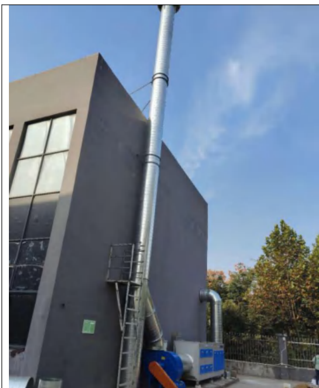
原料仓库、危废仓库废气处理设施
