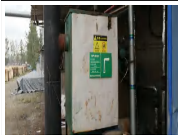
锅炉处理设施
